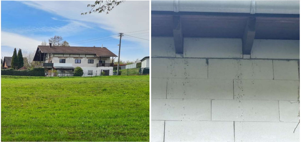
Abbildung 12 a + b: An dem im Westen unmittelbar an das Plangebiet angrenzenden Wohngebäude wurden großflächig Kotspu- ren von Fledermäusen festgestellt
